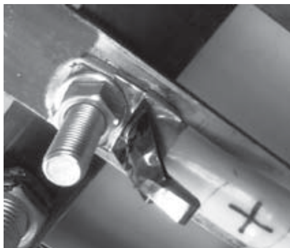
Рис. 4. Индикатор перегрева контактов, смонтированный на кабельном наконечнике
